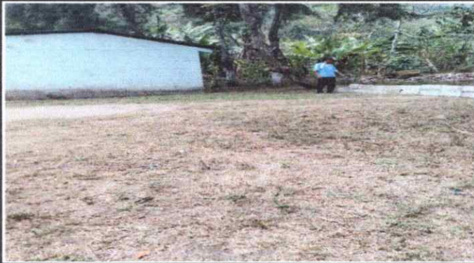
foto 1. SE observa deterioro del muro perimetral
